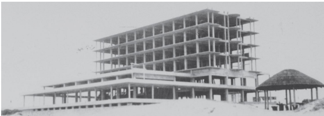
Estructura inconclusa del Hotel sur Mer.
